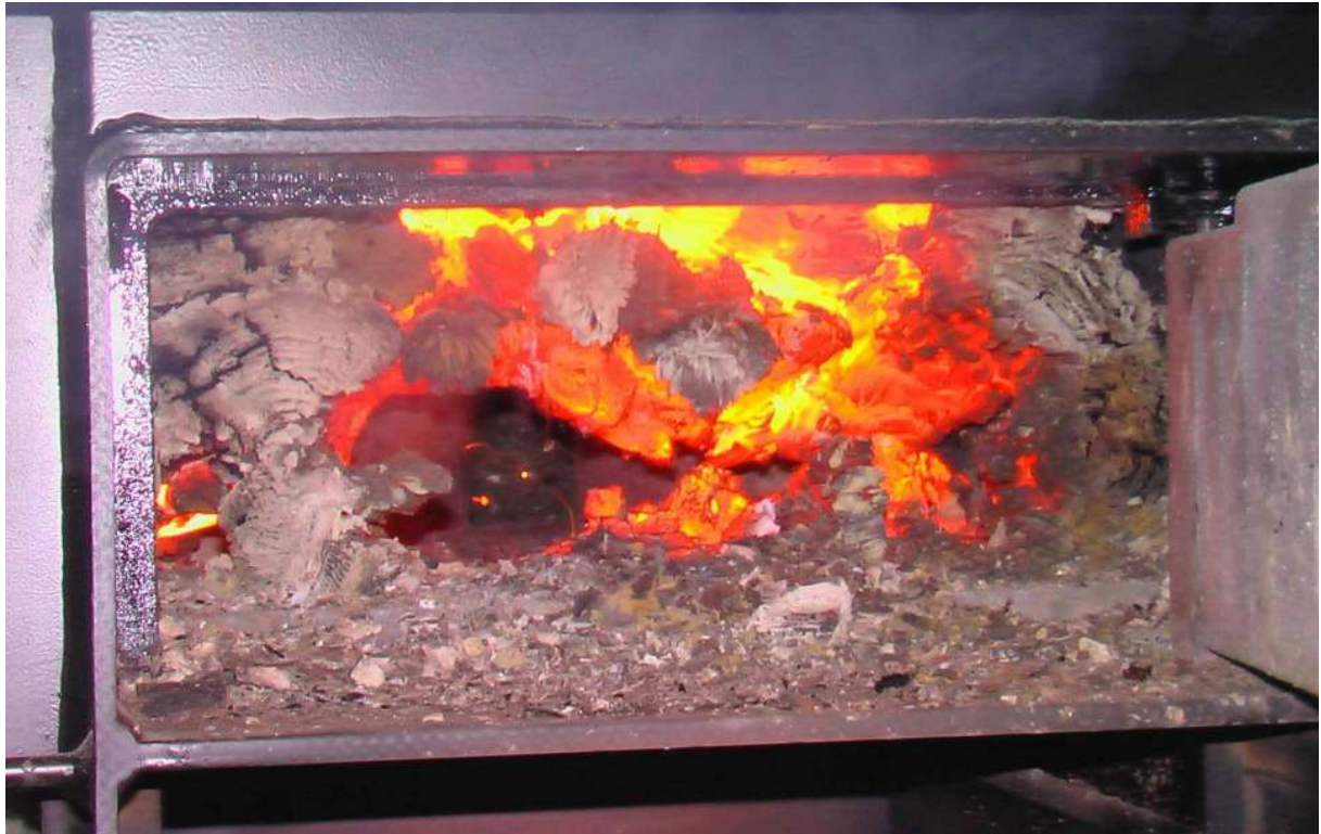
Abbildung 36: Hohlbrand bei einer Scheitholzfeuerung (Fischer). Der Brennstoff bildet eine Brücke über dem Rost. Im Hintergrund die Öffnung für den Heißgasabzug in die Nachbrennkammer
