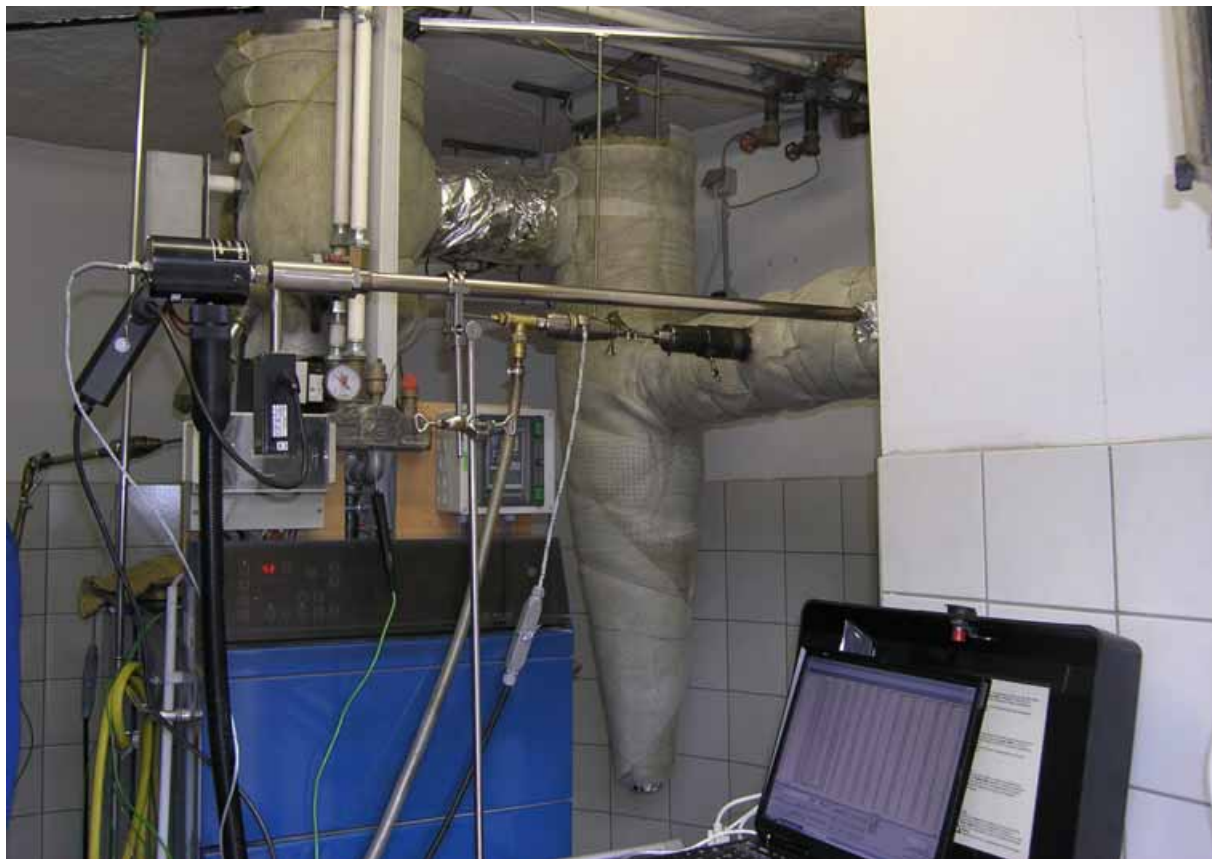
Abbildung 14: Aufbau der Messeinrichtungen bei der Messung an der Praxisanlage
