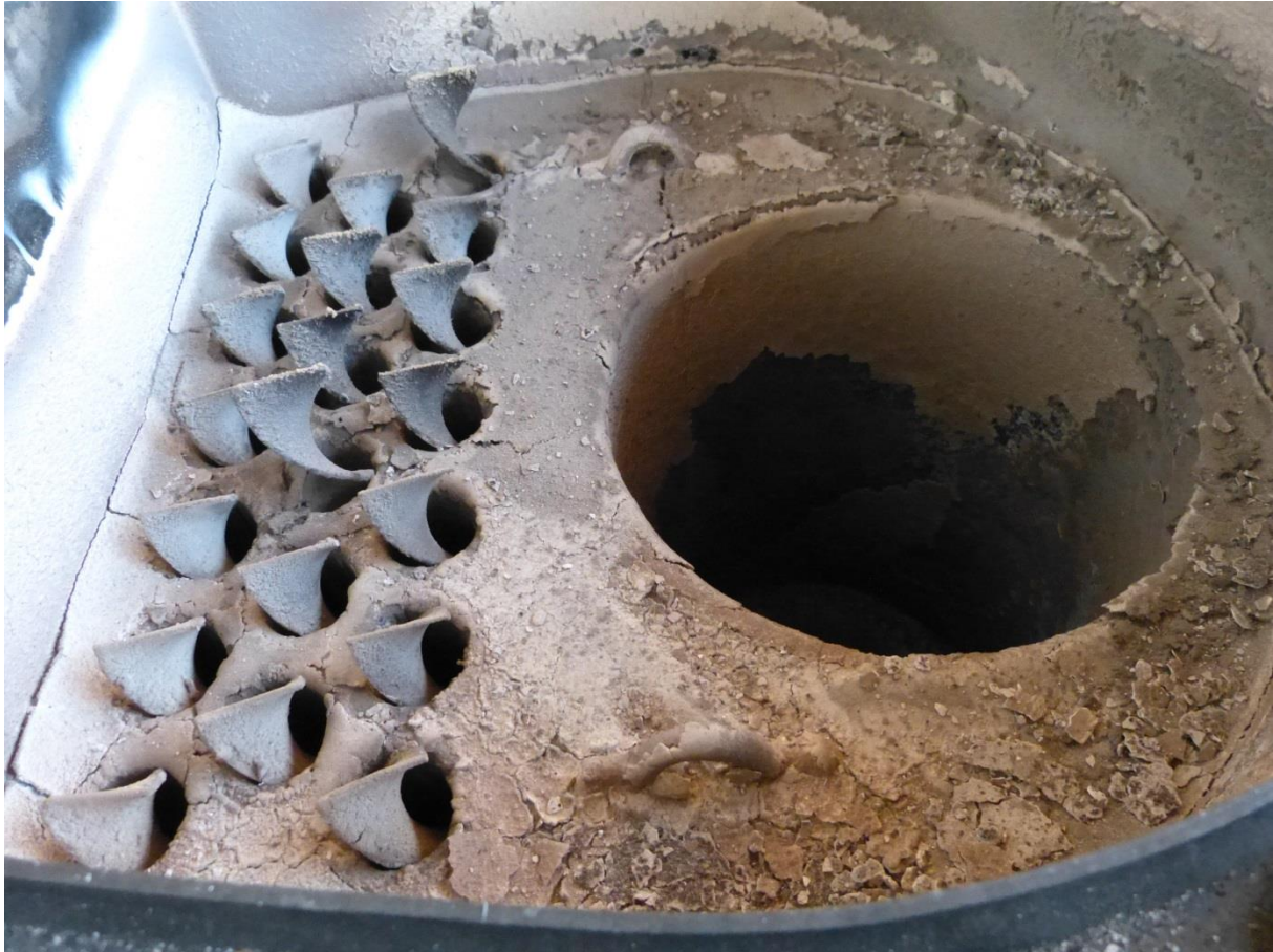
Abbildung 34: Ablagerungen am Wärmetauscher des Kessels nach einem Versuchstag (8 h Vollastbetrieb + 2 h Aufheizdauer) mit reinen Graspellets
