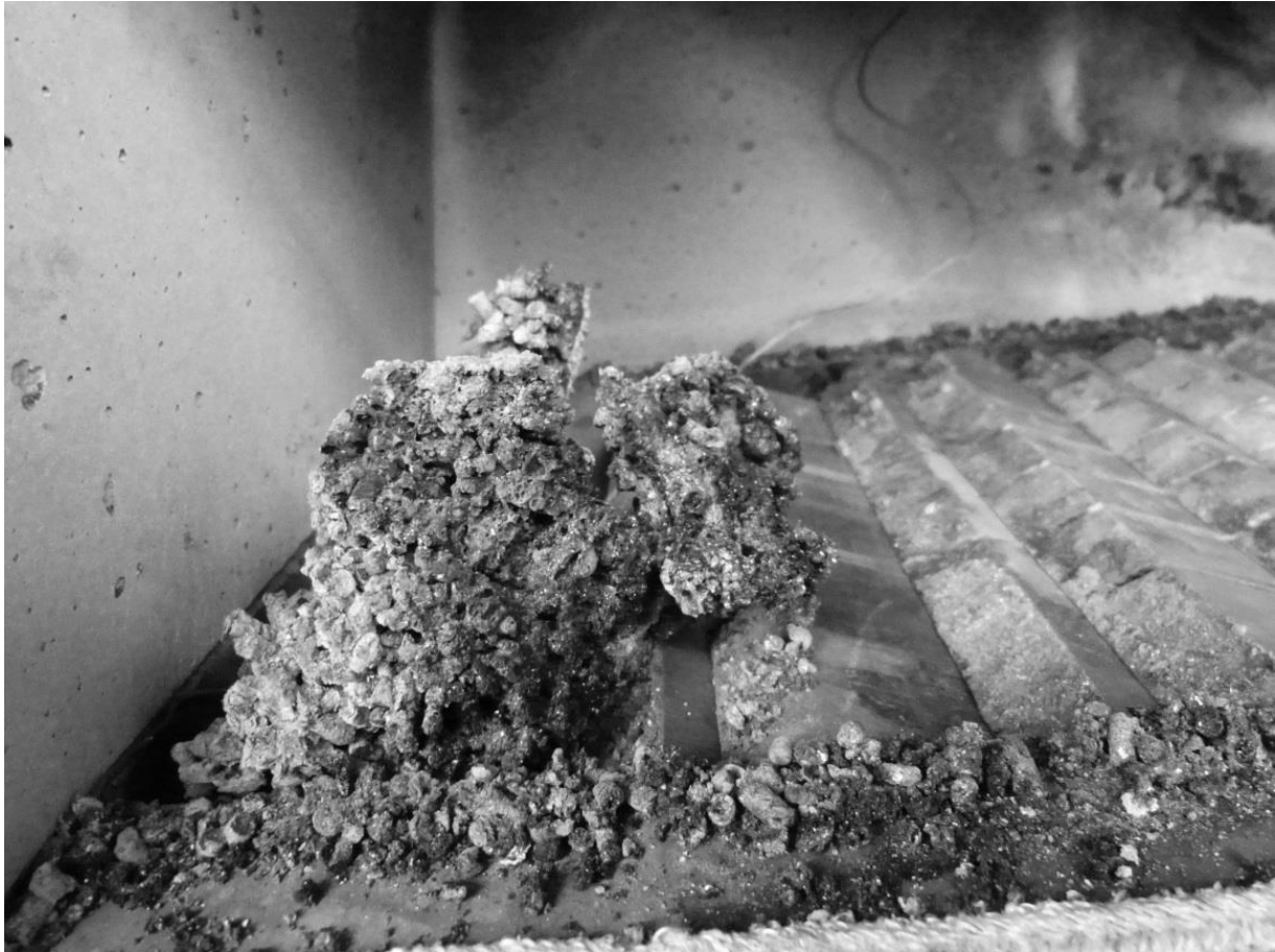
Abbildung 14: Schlackebrocken verstopfen die Entschungsöffnung bei der Verbrennung reiner Weizenstrohpellets im 30-kW-Kessel
