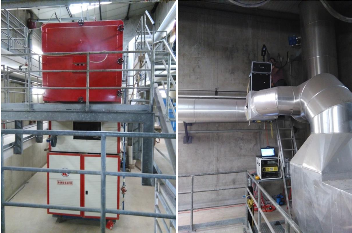
Abbildung 8: Kessel- und Wärmetauschereinheit der Feldanlage 2 (links) und Messaufbau während der Feldmessungen (rechts)
