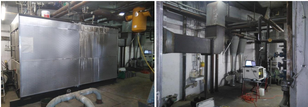
Abbildung 6: Feldanlage 1 mit dem Lambion-Kessel (links) und den Zyklonen sowie der Messanordnung während der Feldmessungen (rechts)
