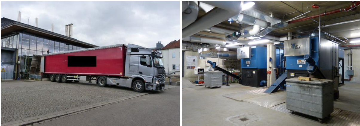
Abbildung 3: Anlieferung von Holzhackschnitzeln im Lkw direkt in den Bunker (links) und Heizkessel des TFZ-Heizwerks mit Aschecontainern im Vordergrund (rechts)
